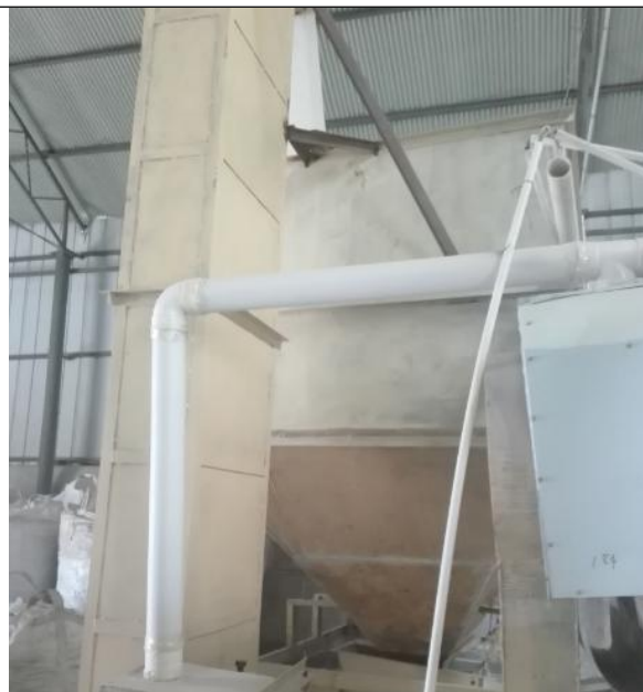
破碎 2 至分选工序公用袋式除尘器
