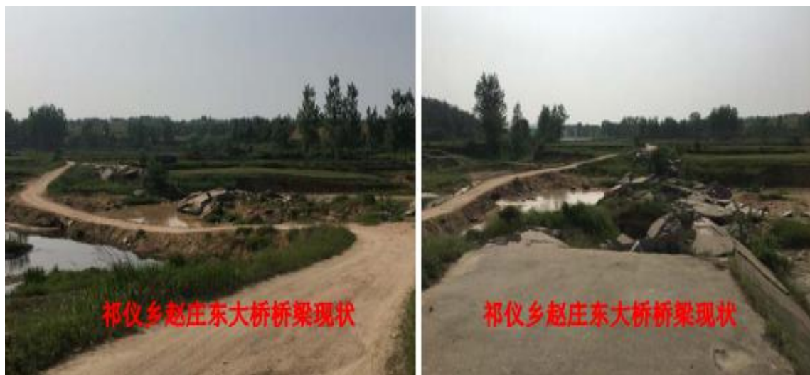
附图 3 现有桥梁现状
