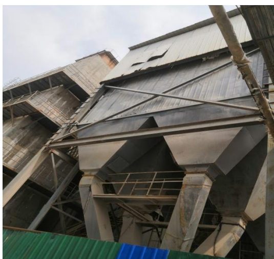
除尘脱硫措施
