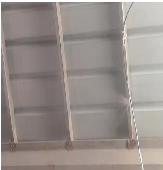
骨料库库顶的喷雾抑尘装置
