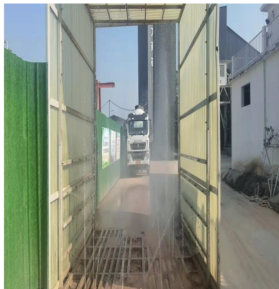
车辆冲洗装置
