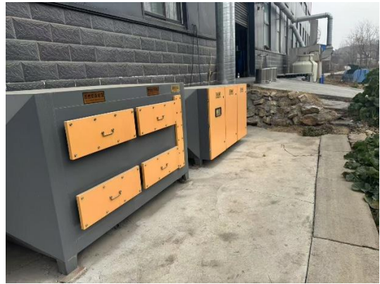
现有厂区废气治理设施
