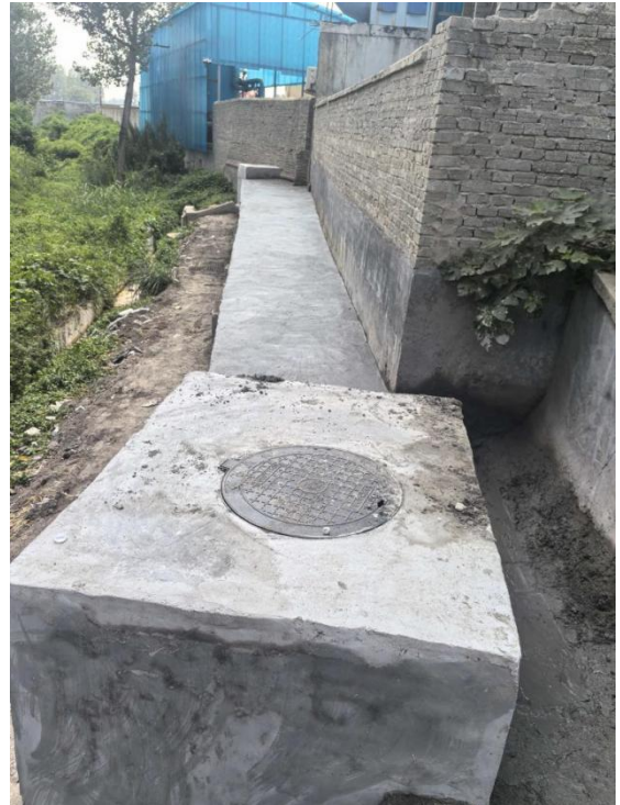
本次厂区外排污管线及监测井
